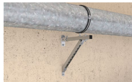
Strutture di supporto per sistemi di ventilazione.
