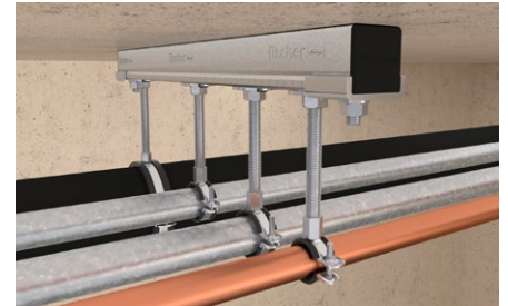
Tubazioni leggere a soffitto.
